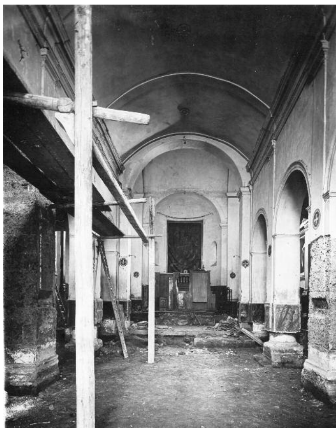
Fig. 3. Civita Castellana (Viterbo). L'interno di San Gregorio Magno in una foto del 1934. Si osservano le prime operazioni di rimozione della pavimentazione e degli intonaci in corrispondenza dei pilastri (su concessione della Soprintendenza Belle Arti e Paesaggio per le province di Roma, Frosinone, Latina, Rieti e Viterbo, numero di negativo 3932, anno 1934).
