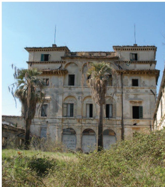
Fig. 10. Terni, prospetto principale di villa Palma, stato di fatto al 2012. Oggi purtroppo le strutture della villa hanno subito un inesorabile decadimento (foto di G. Castellini Rinaldi).
