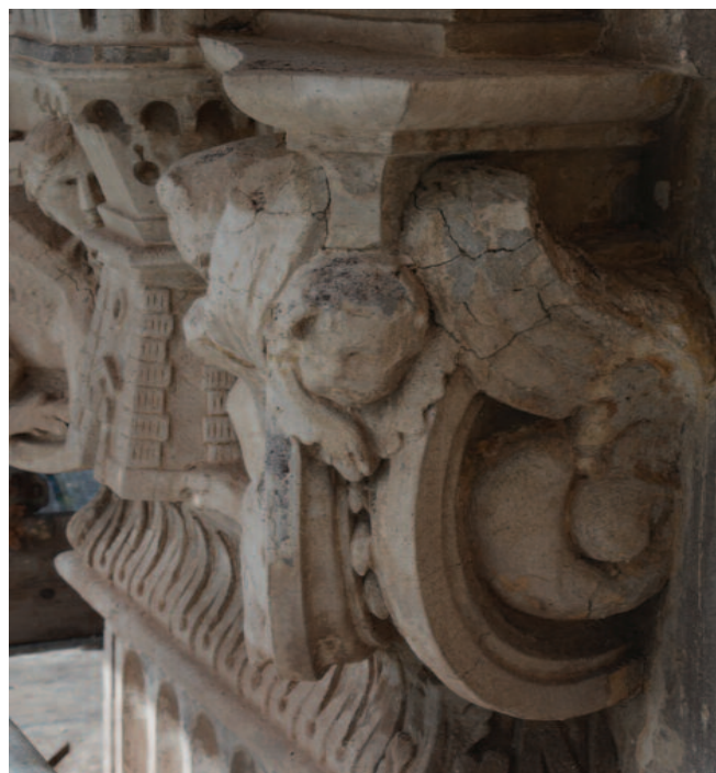
Fig. 19. Roma, Santa Maria del Priorato, particolare con gli ornati in stucco dei capitelli della facciata prima dell'intervento di restauro del 2017-2019 (foto G. Ferreri).
